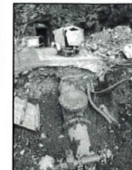
Près de 4 km de tuyaux traversent la montagne pour acheminer l'eau à l'usine de production située 2800 mètres en aval de l'entrée de la galerie.
